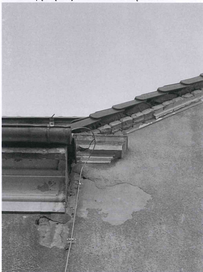
Widoczny brak obróbek blacharskich po wymianie pokrycia dachowego oraz widoczne ubytki w tynku a także a także w warstwach spoin między cegłami
