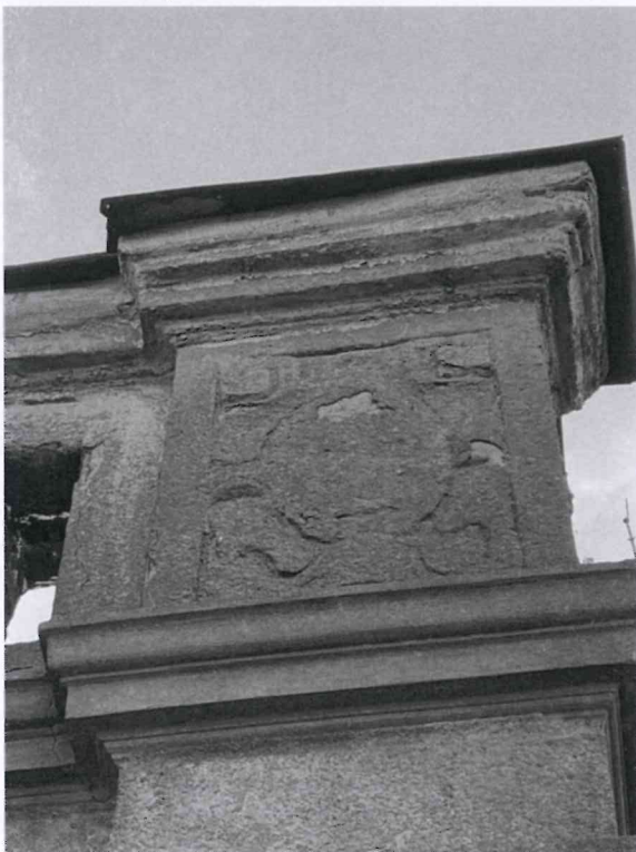
Taras – widoczne uszkodzenia balasek oraz ornamentowań. Widoczne odspojenia tynku oraz uszkodzone warstwy farby i tynku
