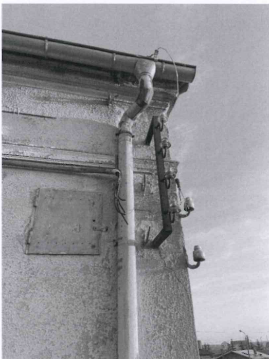
Stare rury spustowe oraz elementy po zdemontowanej linii elektro-energetycznej – przeznaczone do usunięcia Widoczne pęknięcia tynku oraz odchodząca farba
