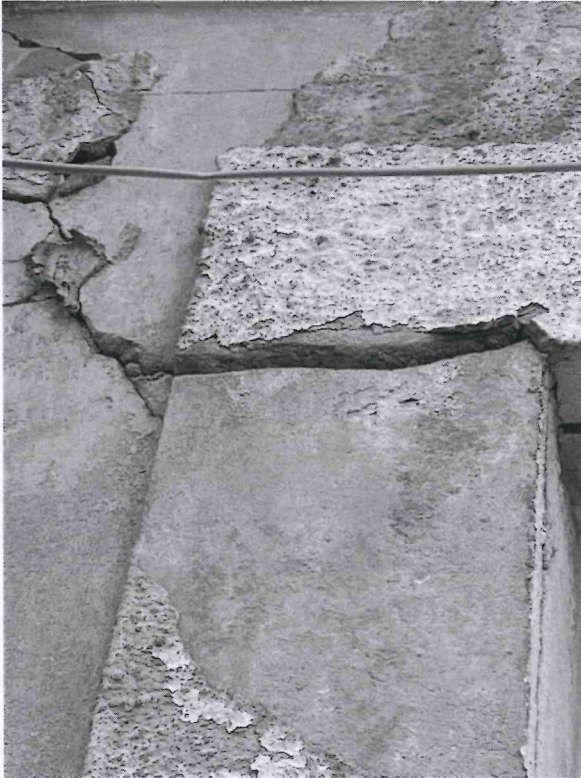
Widoczne ukośne pęknięcia budynku oraz zdegradowany tynk oraz „spuchnięte” warstwy farby oraz widoczne uszkodzenia tynku
