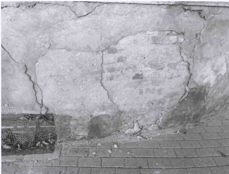
Fragment cokołu elewacji frontowej Widoczna ściana piwnicy oraz wielowarstwowe naprawy tynku cementowo-wapiennego cokołu oraz odspojenia tynku spowodowane zawilgoceniem ściany od wody opadowej. Widoczny brak izolacji pionowej ściany fundamentowej.
