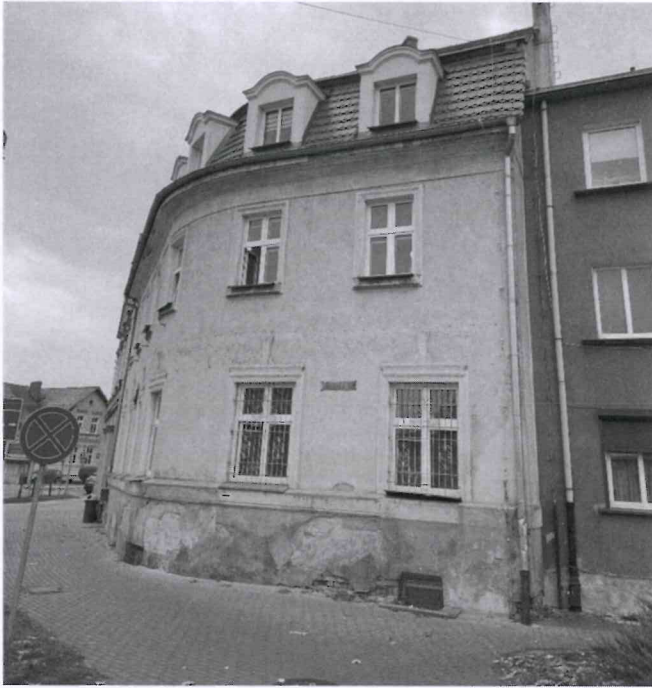
Fragment elewacji północno- wschodniej – dalsza część elewacji frontowej Widoczne duże ubytki w cokole budynku oraz widoczna jest degradacja spowodowana przez zawilgocenie ścian piwnicy.
