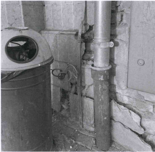
Elewacja po prawej stronie wejścia głównego do budynku Płytki ceramiczne elewacyjne częściowo odspojone. Tynk cementowo-wapienny na cokole budynku – widoczne odparzenia tynku oraz odspojenia. Rynna bez wykonanej rewizji – wprowadzona do kanalizacji deszczowej w pasie drogowym
