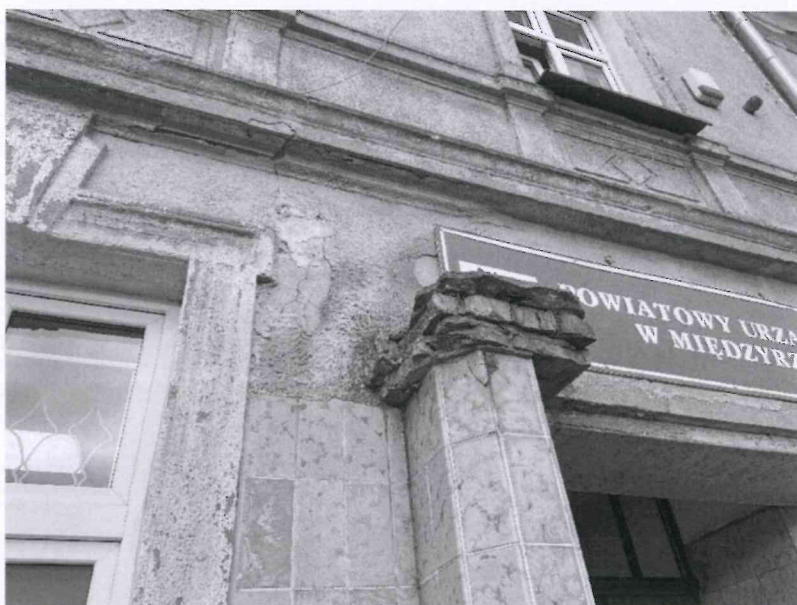
Widoczne uszkodzenia zwieńczeń kolumniek przy wejściu głównym do budynku. Płytki ceramiczne przy wejściu – przeznaczone do skucia.
