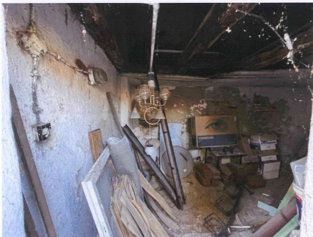
Pomieszczenia gospodarcze – wejście od strony elewacji tylnej budynku – widoczne tynki w złym stanie technicznym – do skucia
