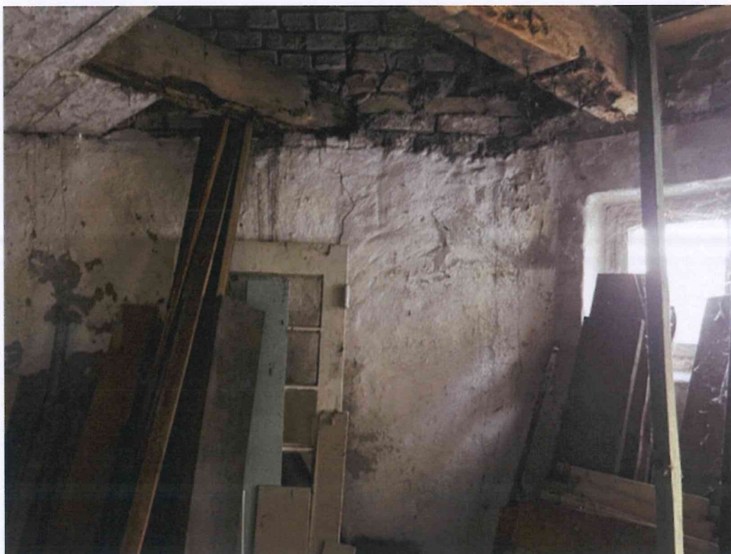
Pomieszczenia gospodarcze – wejście od strony elewacji tylnej budynku – widoczne tynki w złym stanie technicznym – do skucia oraz stare belki stropowe – do rozbiórki
