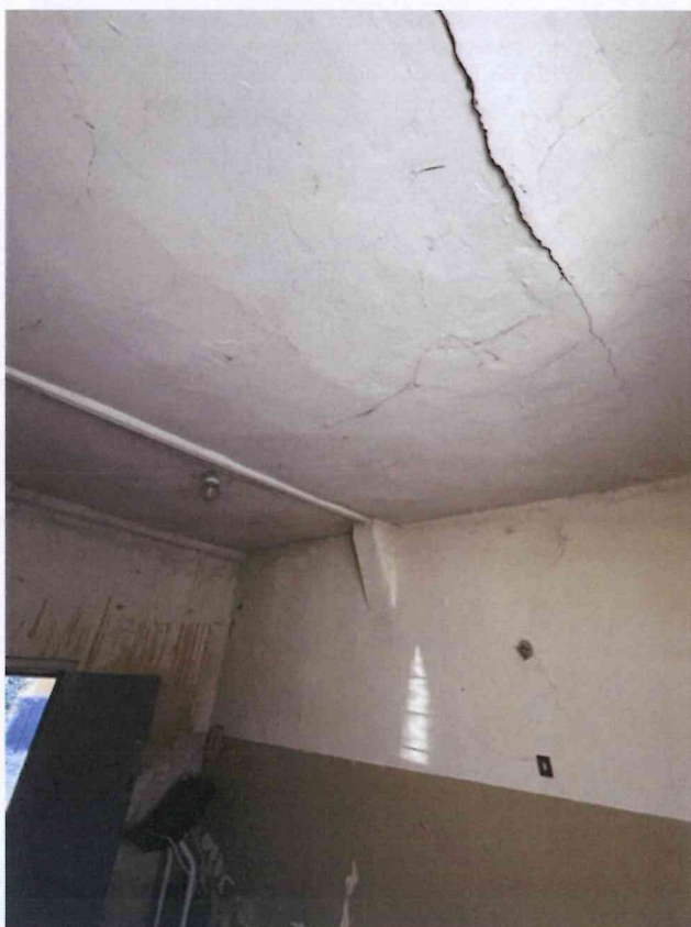
Pomieszczenia gospodarcze – wejście od strony elewacji tylnej budynku – widoczne spękania sufitu podwieszanego – do rozbiórki
