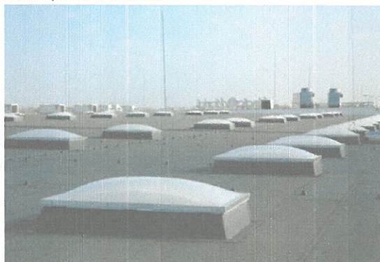
Widok zamontowanych klap oddymiających w dachu.
