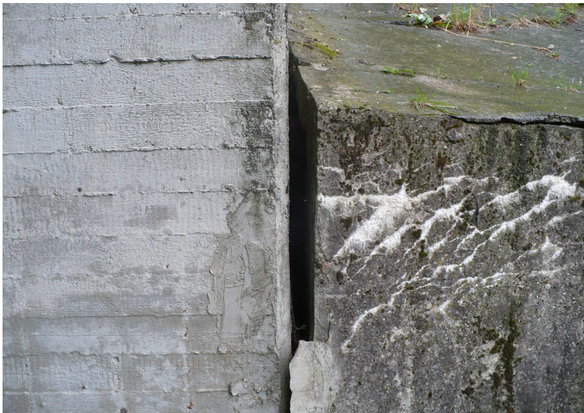
Fot. Nr 14. Betonowy mur oporowy podtrzymujący betonowe zabezpieczenie powierzchni stożka lewobrzeżnego od strony dolnej wody odchylił się od krawędzi korpusu przyczółka o około 6,0 cm.
