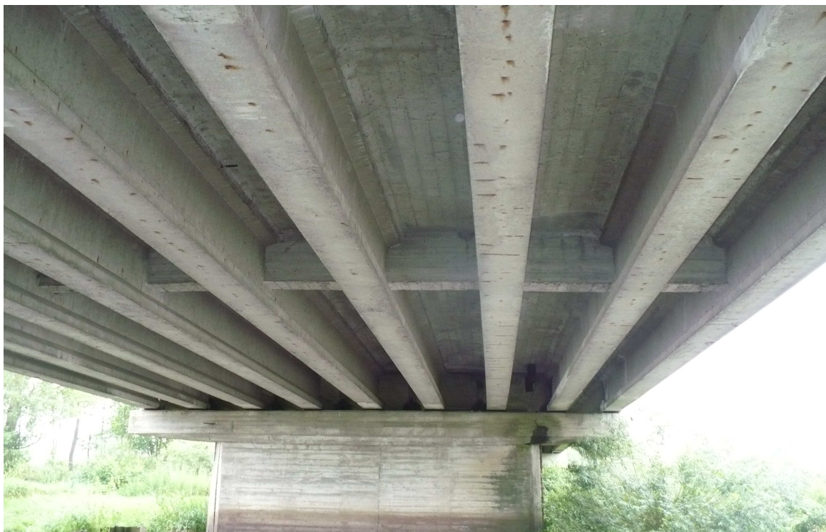
Fot. Nr 15. Widok od spodu na konstrukcję pomostu przęsła lewobrzeżnego. Widoczne białe wykwyty i przebarwienia na powierzchniach płyty pomostu i belkach ustroju niosącego. Korozja elementów stalowych (zbrojenie, drut wiązałkowy, podkładki stalowe) na dolnej powierzchni belek. Przebarwienie betonu oczepu i korpusu filara świadczące o nieszczelnej izolacji i utrzymywaniu się tam wilgotności.
