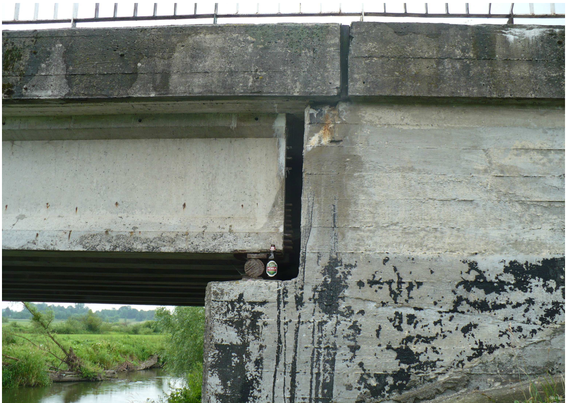
Fot. Nr 10. Widok na strefę przydylatacyjną przyczółka lewobrzeżnego od strony dolnej wody. Brak osłony przerwy dylatacyjnej w zakresie belki podporęczowej. Widoczne efekty nieszczelności urządzenia dylatacyjnego: białe wykwity, wycieki wody, ubytki betonu.
