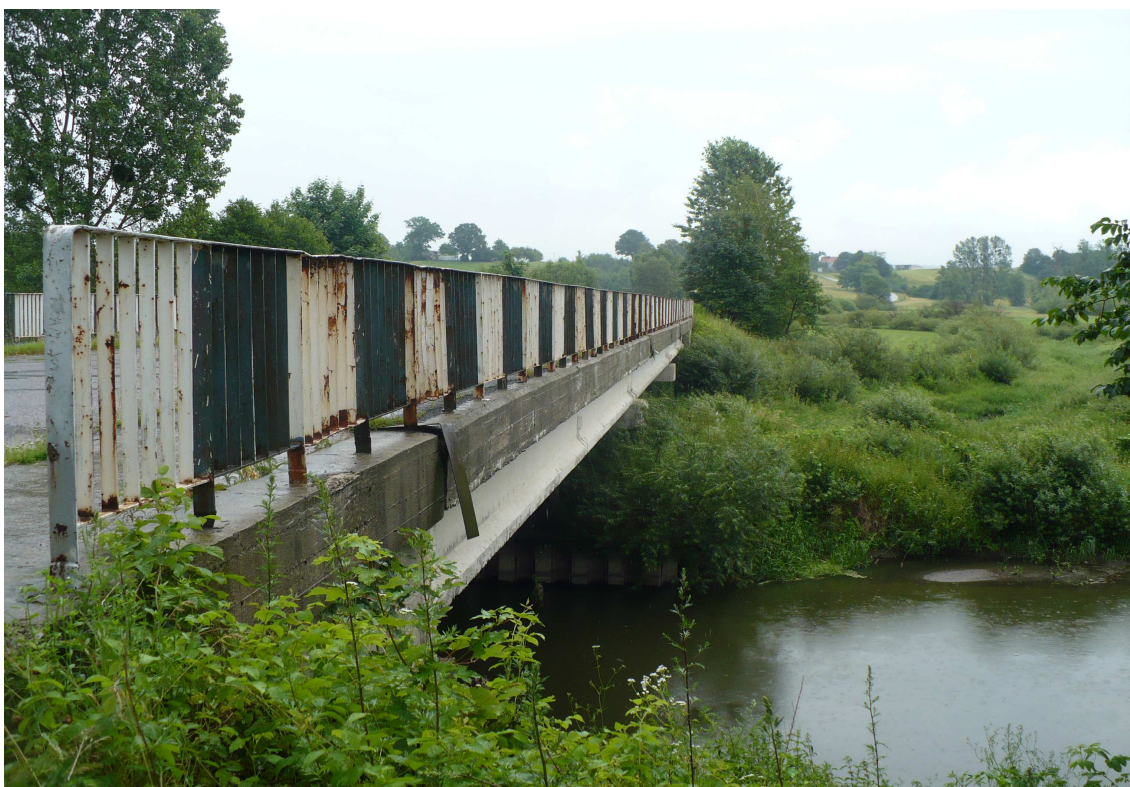
Fot. Nr 4. Widok na most od strony górnej wody. Zniszczenia korozyjne betonu belki podporęczowej, większe w przęśle lewobrzeżnym. Odkształcona korodująca osłona szczeliny dylatacyjnej wykonana z blachy stalowej. Otoczenie mostu zarośnięte krzakami i roślinnością trawiastą.
