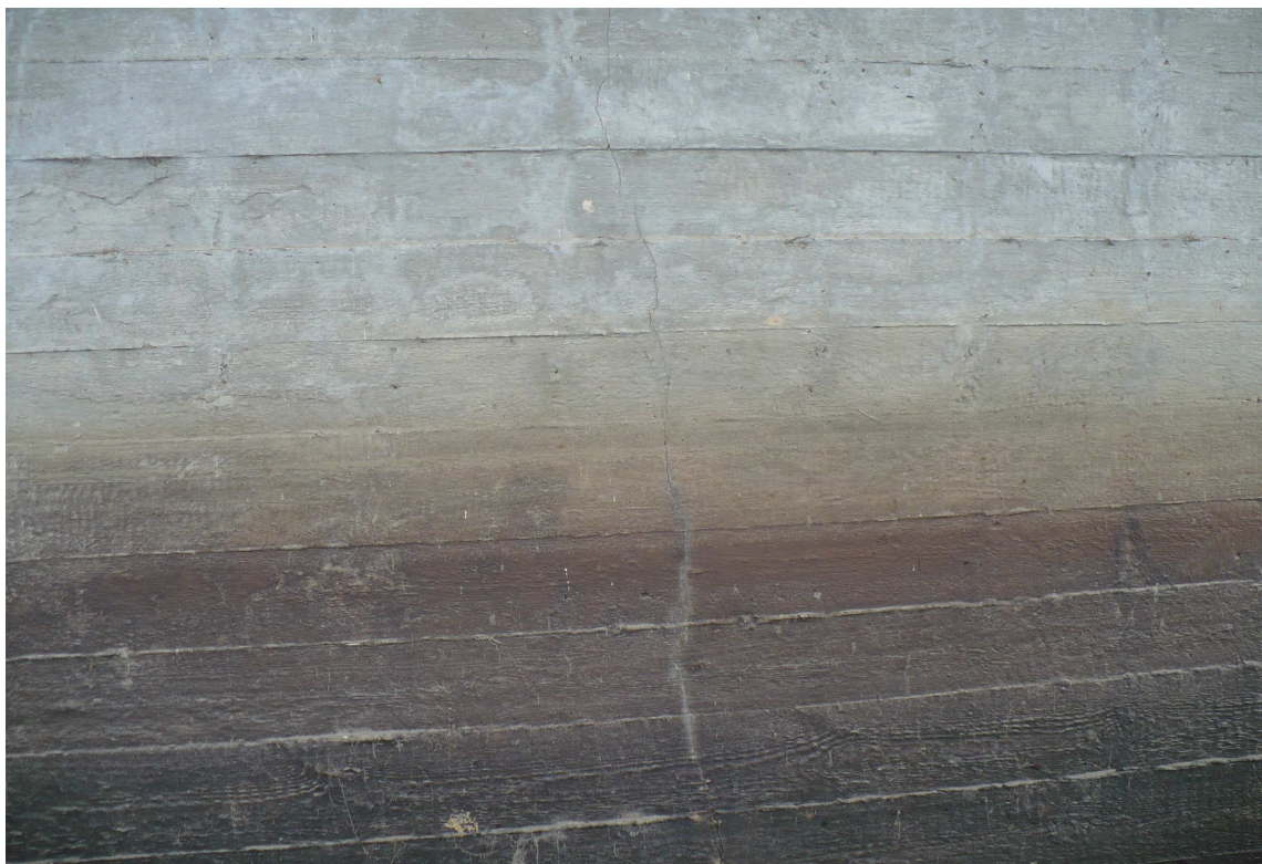
Fot. Nr 11. Ściana przyczółka lewobrzeżnego. W środku długości ściany widoczna jest rysa pionowa. Pomierzone rozwarście rysy dochodzi do 1,0 mm. Na widocznej części ściany występują lekkie przebarwienia liniowe pochodzące od wody spływającej z powierzchni ławy podłożyskowej.
