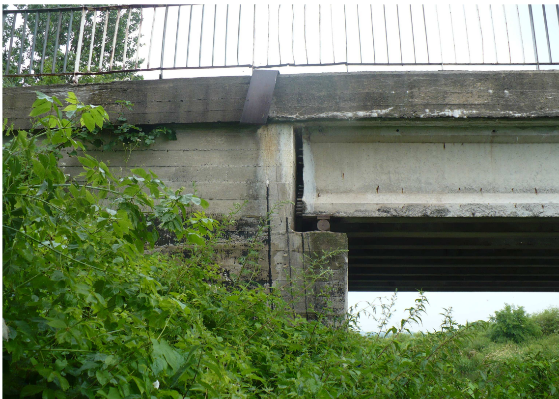
Fot. Nr 25. Strefa przydylatacyjna nad przyczółkiem lewobrzeżnym od strony górnej wody. Korozja betonu belki podporęczowej i przyczółka. Białe osady świadczące o wyciekach wody w wyniku nieszczelności izolacji i urządzenia dylatacyjnego. Korozja wszystkich elementów stalowych (końcówki strun w belkach, łożysko wałkowe i osłona szczeliny dylatacyjnej)
