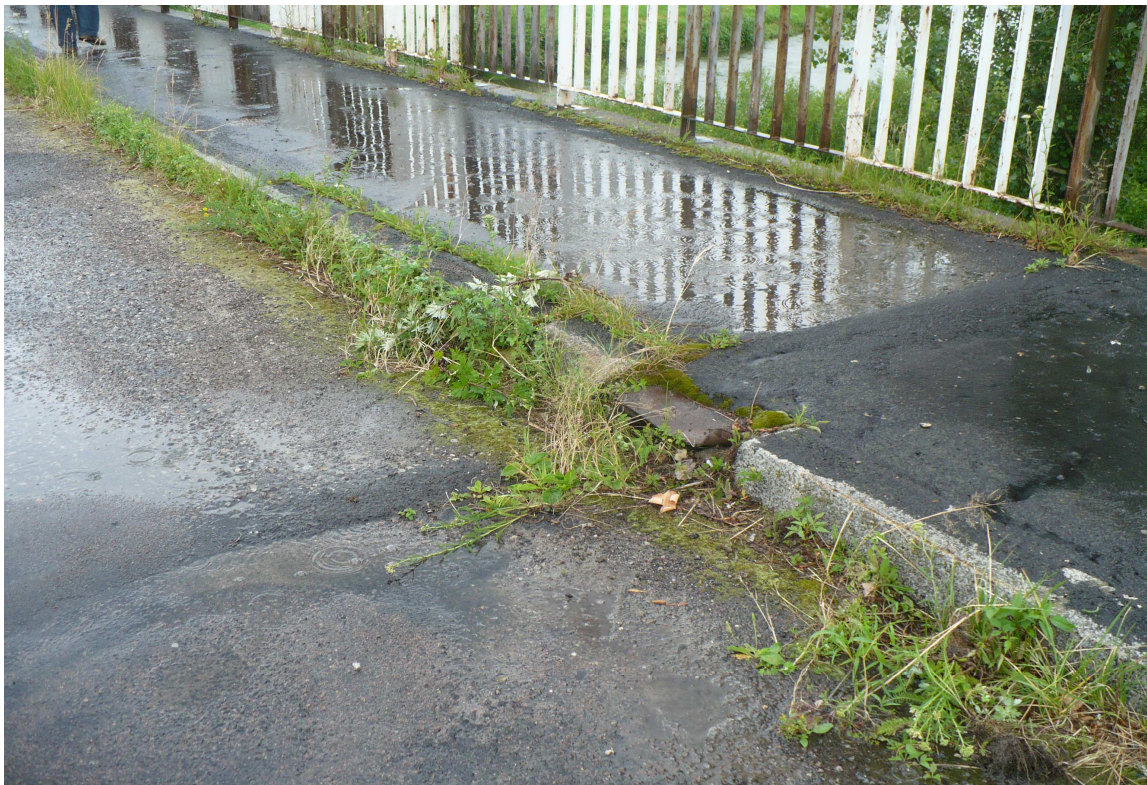
Fot. Nr 9. ściek podchodnikowy nad filarem prawobrzeżnym od strony górnej wody. Zdeformowana krawędź przykrywy wnęki dylatacyjnej, korozja stali elementu przykrywającego. Podobnie wyglądają wszystkie ścieki podchodnikowe na moście.
