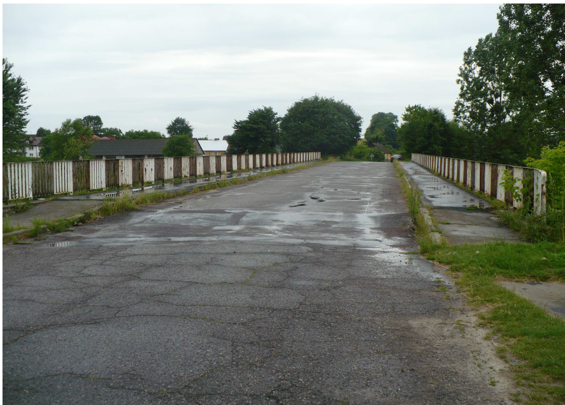
Fot. Nr 2. Widok od strony Tarczyniechów. Na długości skrzydełek chodniki zanikają do poziomu jezdni. Wzdłuż linii krawężników nagromadzone są zanieczyszczenia sprzyjające wegetacji roślinności. Nawierzchnia jezdni na dojazdach jest silnie porysowana z ubytkami i deformacjami.
