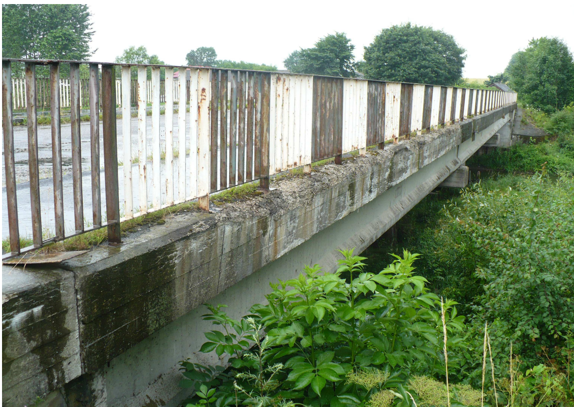
Fot. Nr 3. Widok od strony dolnej wody. Bardzo duże zniszczenia korozyjne betonu belki podporęczowej w przęśle prawobrzeżnym. Lokalnie odsłonięte korodujące zbrojenie. Brak elementu pionowego w osłonie stalowej przykrywającej szczelinę dylatacyjną nad przyczółkiem, a korodująca część pozioma jest uniesiona. Otoczenie mostu zarośnięte krzakami i roślinnością trawiastą.
