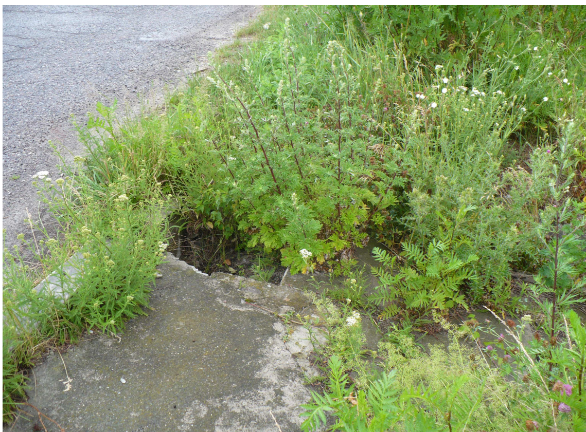
Fot. Nr 8. Ubytek gruntu za prawobrzeżnym chodnikiem zanikającym od strony górnej wody. Stanowi on tym większe zagrożenie, ponieważ jest zasłonięty roślinnością.
