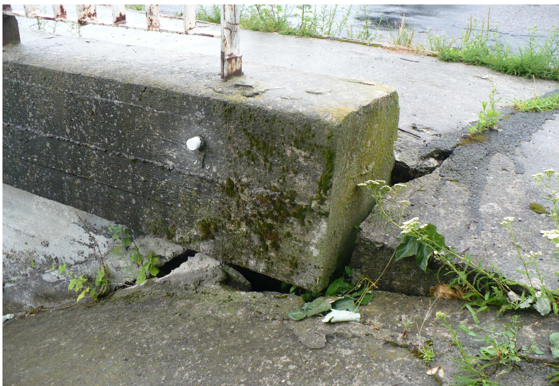
Fot. Nr 26. Ubytek gruntu w rejonie końcówki skrzydła lewobrzeżnego od strony dolnej wody. Chodnik zanikający i zabezpieczenie powierzchni stożka w tym rejonie utrzymują się tylko na zasadzie docisku (jak konstrukcje sklepienne).
