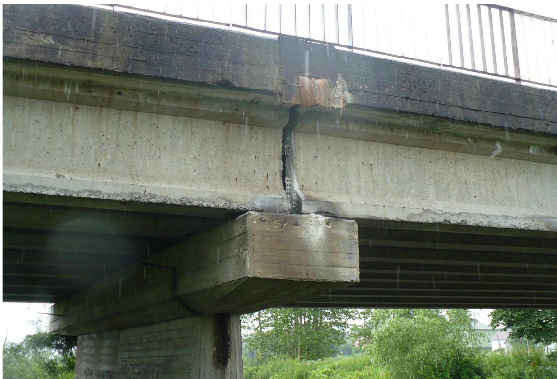
Fot. Nr 20. Wyprowadzenie taśmy urządzenia dylatacyjnego poza obiekt szczeliną wyciętą w korodującej blasze stalowej przykrywającej dylatację nad filarem. Woda spływająca rynienką taśmy pozostawia swoje ślady na powierzchniach betonowych belek i oczepów filarów. Widoczne efekty nieszczelności izolacji – białe osady na górnych półkach belek. Korozja betonu belki podporęczowej.
