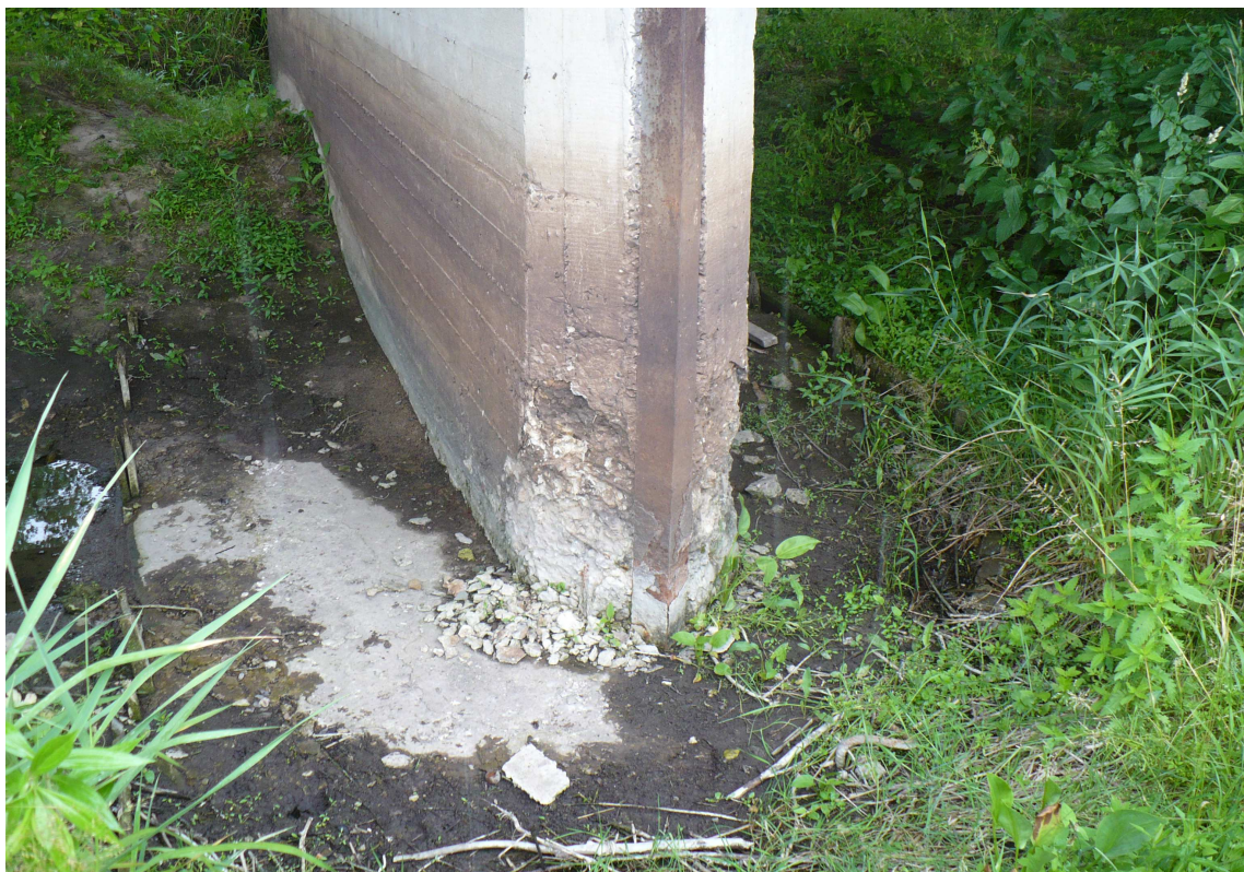
Fot. Nr 17. Widok na dolny fragment filara przęsła prawobrzeżnego od strony górnej wody. Znaczne ubytki betonu dolnej części korpusu filara w otoczeniu stalowego noża izbicznego. Brak zabezpieczenia antykorozyjnego powierzchni kątownika stalowego noża i korozja powierzchniowa.
