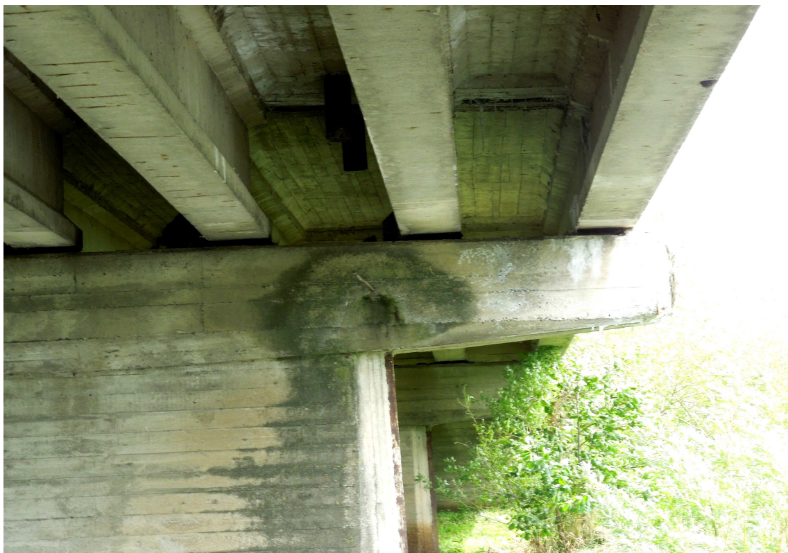
Fot. Nr 21. Filar prawobrzeżny od strony górnej wody. Zawilgocenie betonu w wyniku nieszczelności izolacji pomostu i w urządzeniu dylatacyjnym. Korozja zbrojenia belek. Białe przebarwienia na dolnych powierzchniach płyty pomostu i oczepie filara. Korozja rury spustowej urządzenia odwadniającego.
