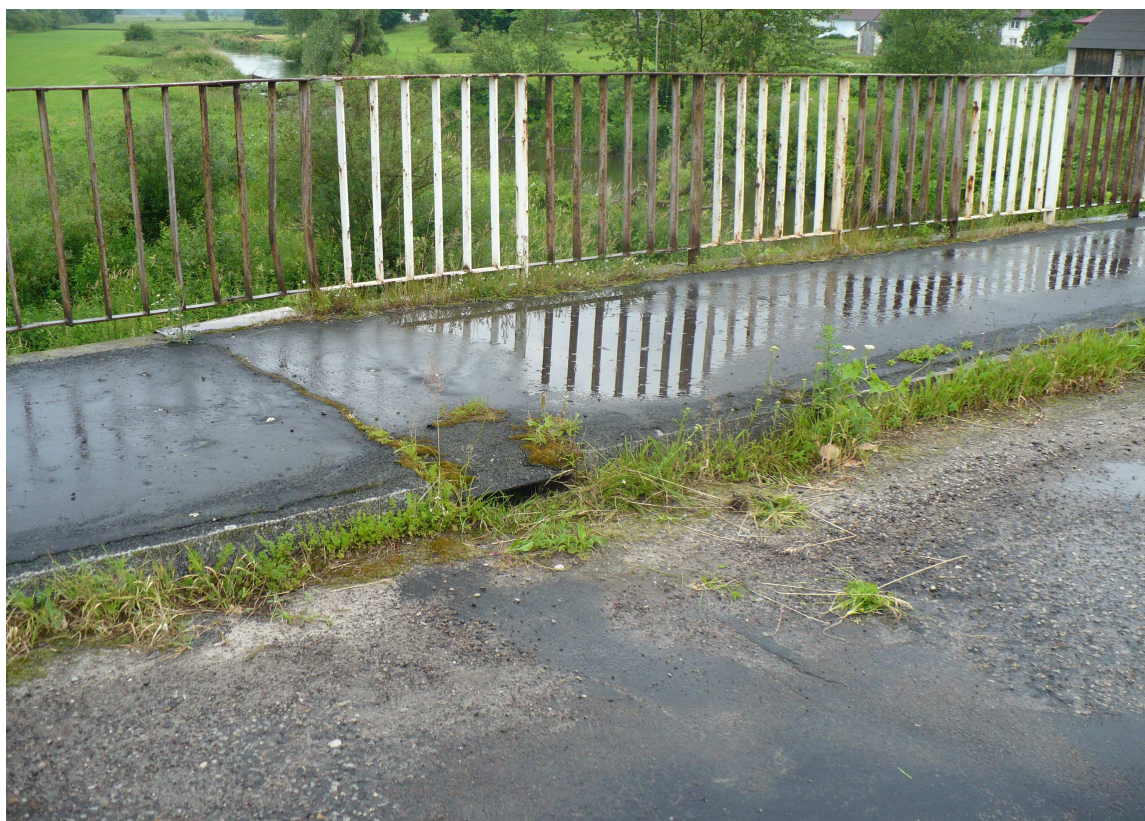
Fot. Nr 6. Odprowadzenie wody z jezdni mostu ściekiem podchodnikowym, którego funkcję pełni wnęką w płycie chodnikowej przykryta blachą stalową. Widoczna część blachy stalowej skorodowana. Nienormatywna wysokość krawężnika nad jezdnią – ok. 6 cm. Zanieczyszczenia nawierzchni jezdni i wegetacja roślinności wzdłuż krawężnika i na krawężniach przykrywy wnęki dylatacyjnej.
