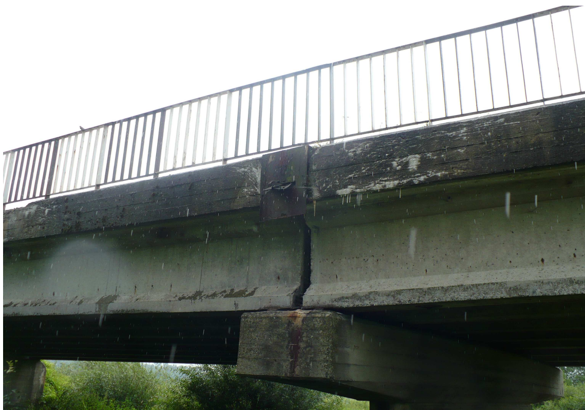
Fot. Nr 23. Widok na belkę podporęczową od strony dolnej wody. Korozja betonu, zniszczenie struktury betonu, białe osady świadczące o wyciekach wody. Rdzawy wyciek widoczny na oczępie filara jest spowodowany wodą spływającą po korodującej powierzchni przykrycia szczeliny dylatacyjnej. Porastanie mchu na dolnych półkach belek – objaw korozji betonu belek.
