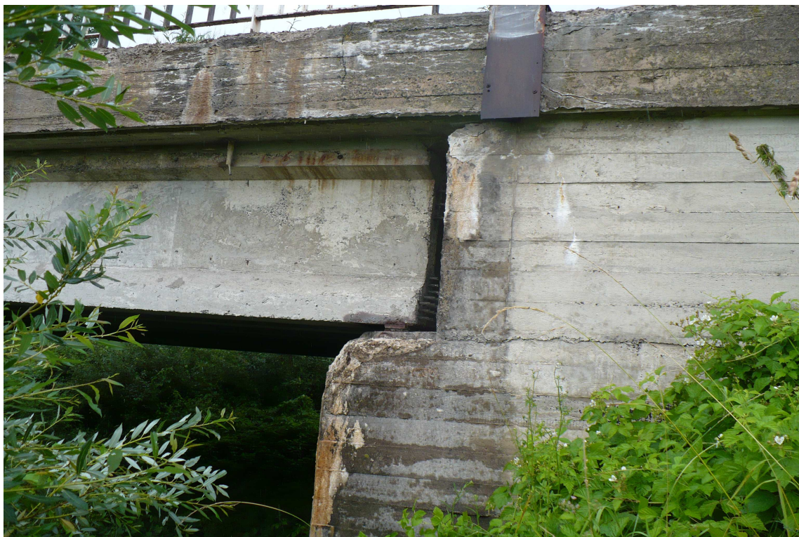
Fot. Nr 19. Strefa przydylatacyjna przyczółka prawobrzeżnego od strony górnej wody. Silna korozja betonu przyczółka i belki podporęczowej. Niezabezpieczone, korodujące elementy stalowe łożyska stałego. Białe osady i wycieki wody. Korodująca blacha elementu osłonowego szczeliny dylatacyjnej.
