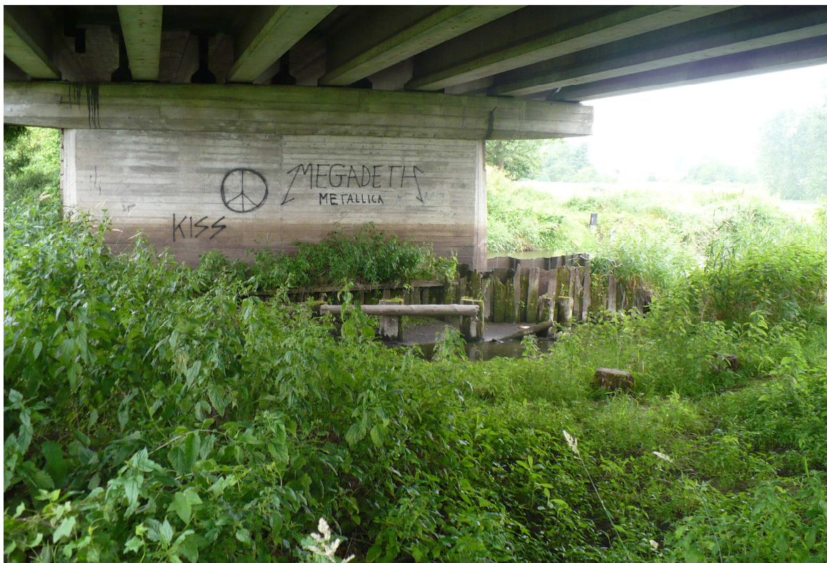
Fot. Nr 16. Teren pod przęsłem środkowym z widokiem na filar przybrzeżny. Pozostałości po moście poprzednim w postaci nieusuniętych pali drewnianych. Nierówno obcięte i korodujące grodzice stalowe ścianki szczelnej, a także nadmiernie wegetująca roślinność nie poprawiają estetyki obiektu. Korozja powierzchni rury spustowej odwodnienia.
