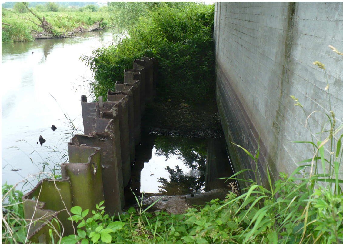
Fot. Nr 13. Otoczenie przyczółka lewobrzeżnego od strony rzeki. Nierówna linia pozostawionych elementów G 62 stalowej ścianki szczelnej. Nieuporządkowana przestrzeń między ścianką stalową i przyczółkiem stwarza utrudnienie w prowadzeniu czynności inspekcyjnych.
