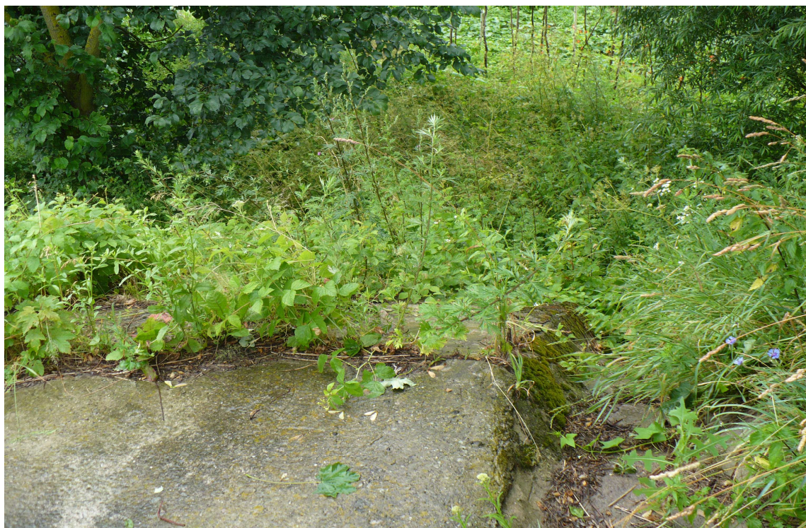
Fot. Nr 24. Widok od góry na stożek przy przyczółku lewobrzeżnym i ściek skarpowy. Zabezpieczenie powierzchni stożka stanowi skorupa betonowa popękana w wielu miejscach. Taka sytuacja sprzyja wegetacji roślinności, co jest przyczyną pogłębiania się uszkodzeń. Istniejący ściek w niewielkim stopniu spełnia swoje zadania.
