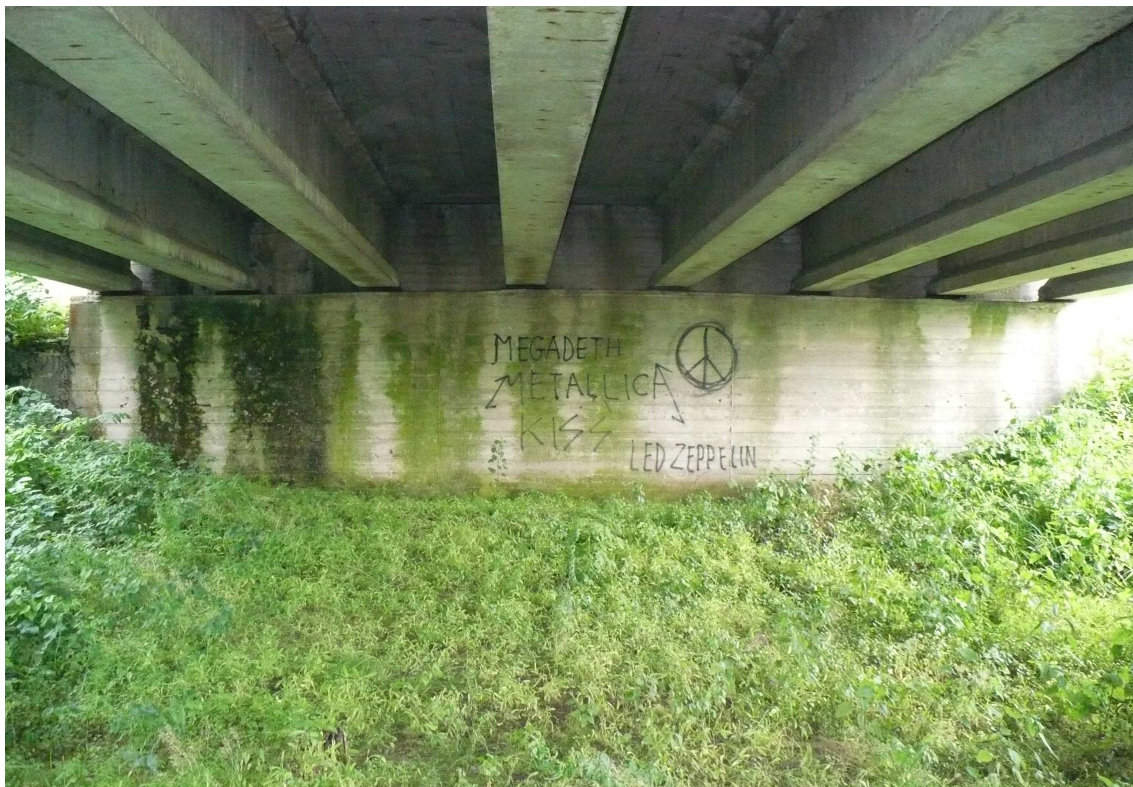
Fot. Nr 18. Ściana przyczółka od strony Tarzymiechów (prawobrzeżnej). Widoczne efekty nieszczelności urządzenia dylatacyjnego nad przyczółkiem. Silne przebarwienia, szczególnie od strony dolnej wody, wskazują na stopień korozji betonu. Widoczne są również białe osady na dolnych powierzchniach belek i płycie pomostu. Korozja zbrojenia uwidoczniona na dolnych powierzchniach belek.
