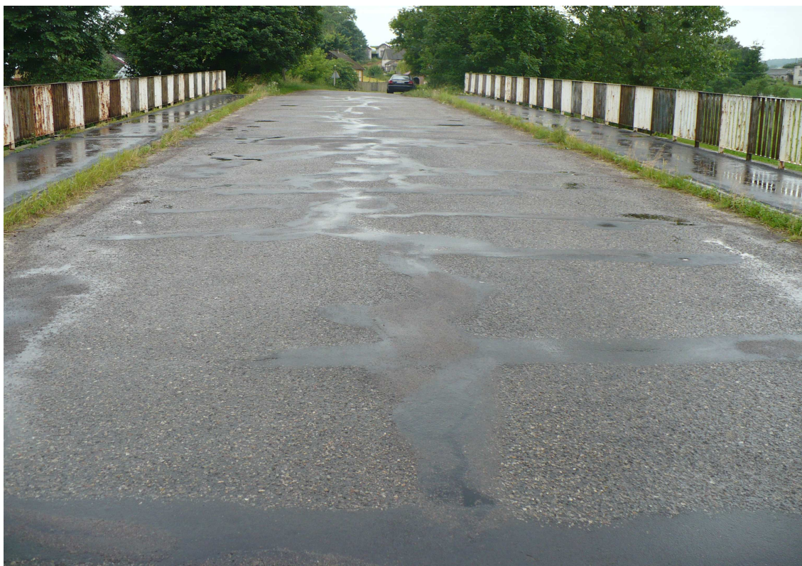
Fot. Nr 7. Nawierzchnia jezdni na moście. Widoczne są deformacje nawierzchni, lokalne zagłębienia, które wypełnione zostały wodą deszczową. Na całej powierzchni mostu widoczne są miejsca napraw dokonywanych w poprzednich okresach. Zanieczyszczenia i wegetacja roślinności.
