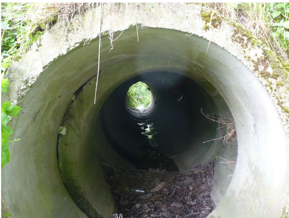
Fot. 6. Widok na lewy otwór przepustu od strony wlotu. Brak współosiowości ułożonych kręgów przepustu świadczy o przynajmniej dwukrotnym jego poszerzaniu. Wzajemne przesunięcia i w poziomie i w pionie dochodzą do 20 cm. W każdym z otworów przepustu wbudowanych jest po 14 kręgów żelbetowych.
