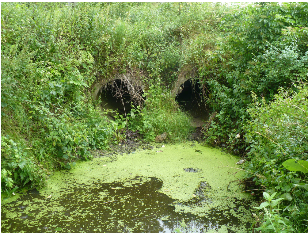
Fot. 3. Widok na przepust od strony wylotu. Brak głowicy wylotowej. Widoczne jest rozlewisko w obniżeniu terenowym za przepustem. Skarpy korony nasypu drogowego pokryte nadmiernie rozwiniętą roślinnością.
