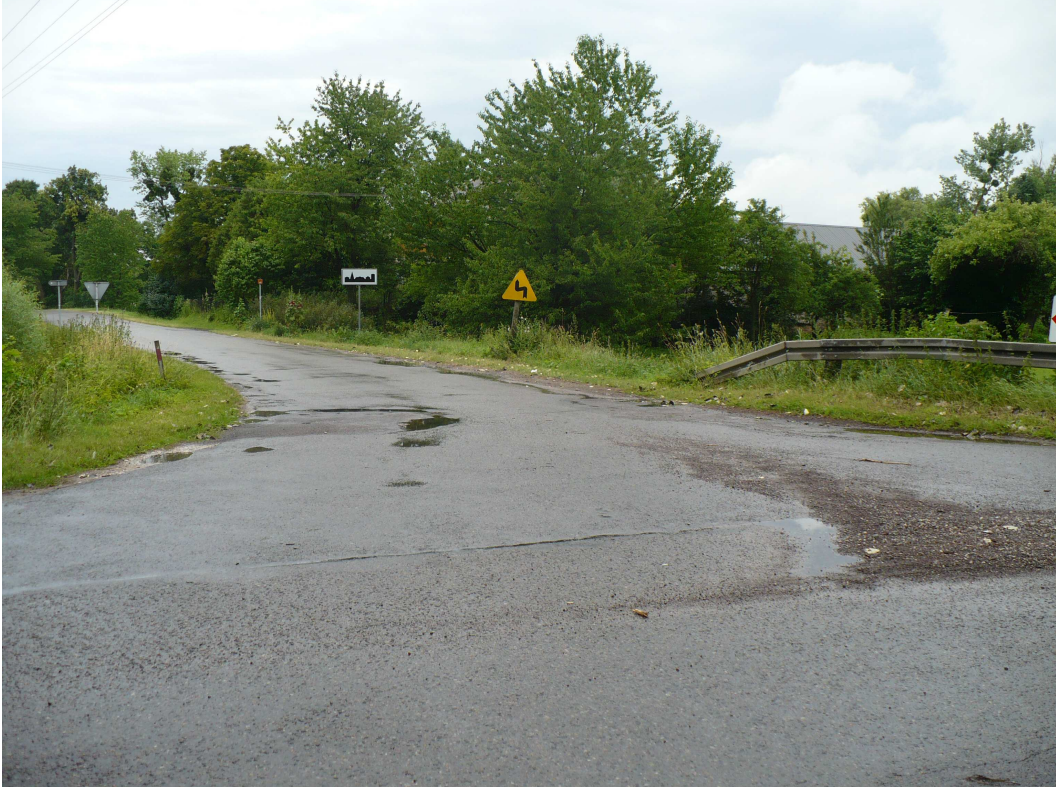
Fot. 1. Widok na jezdnię nad przepustem. Przepust usytuowany jest w miejscu rozwidlenia dróg. Parametry geometryczne rozwidlenia dróg były zmieniane w czasie. W związku z tym przepust był prawdopodobnie 2 razy wydłużany od strony wlotu. Widoczne zanieczyszczenia i deformacje nawierzchni jezdni.
