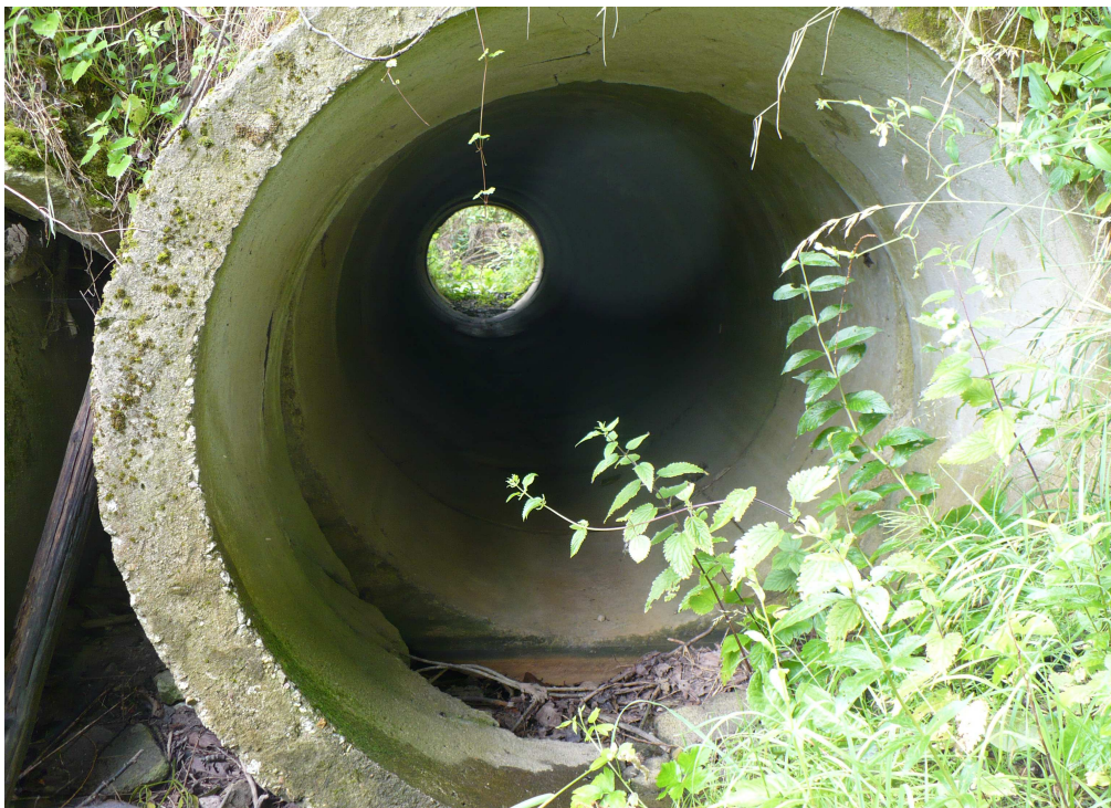
Fot. 5. Widok na prawy otwór przepustu od strony górnej wody. Poprzemieszczane kręgi z licznymi uszkodzeniami (ubytki betonu, rysy i pęknięcia, korozja stali). Brak gruntu wypełniającego przestrzeń między skrajnymi kręgami otworów przepustu.
