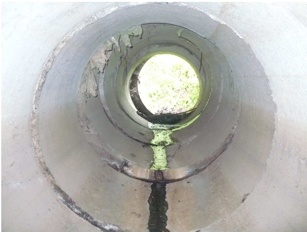
Fot. 7. Wnętrze lewego otworu przepustu. Widoczne przemieszczenia wzajemne kręgów przekraczają grubość elementu. Między kręgami, szczególnie od strony wlotu występują szczeliny poprzez które może być wmywany grunt zasyпки.
