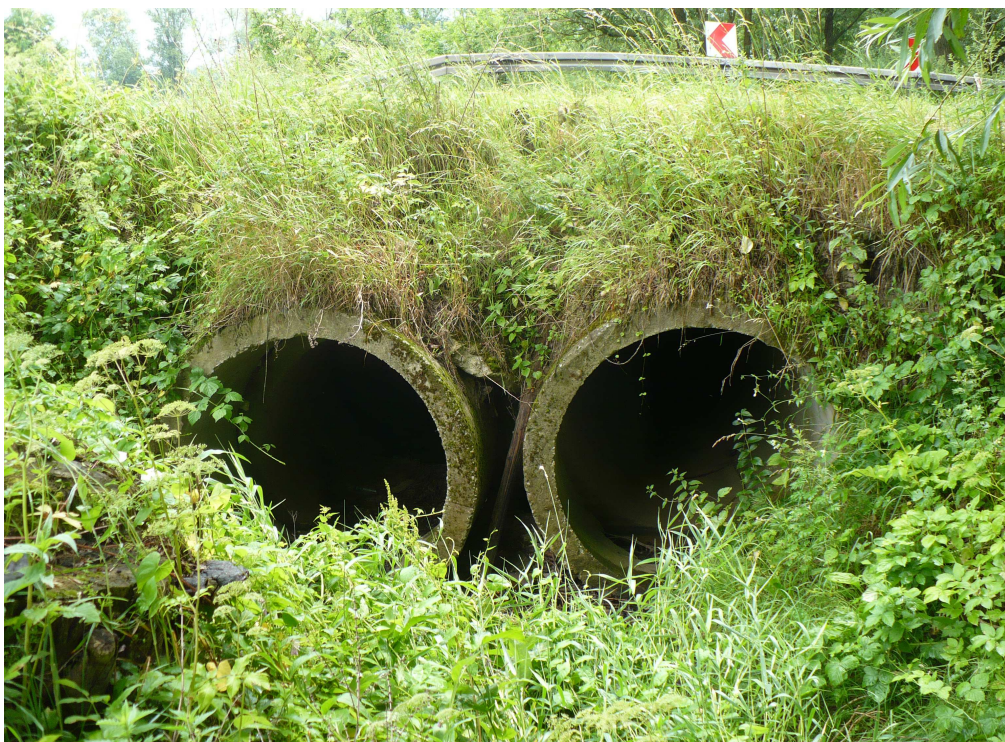
Fot. 4. Widok na przepust od strony wlotu. Brak głowicy wlotowej. Niewypełniona gruntem przestrzeń między skrajnymi rurami przepustu. Skarpy korony nasypu drogowego pokryte nadmiernie rozwiniętą roślinnością.
