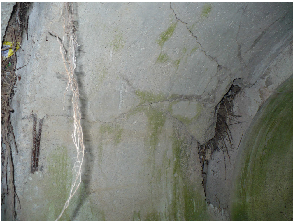
Fot. 8. Rysy, pęknięcia ubytki betonu i wycieki wody w rurach żelbetowych. Szczeliny między rurami wypełnione gruntem. Taki stan podstawowych elementów obiektu wskazuje na konieczność jego przebudowy.
